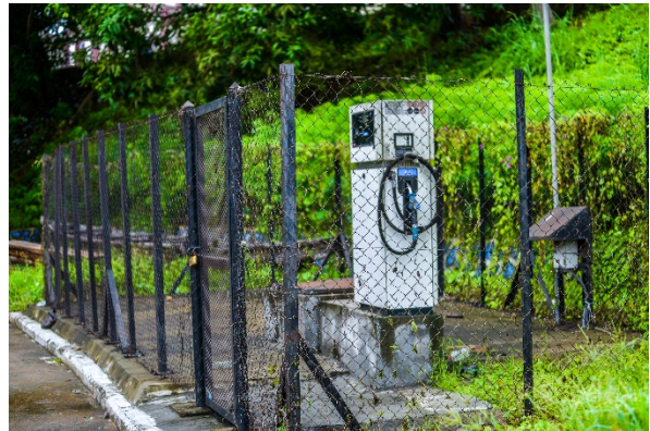
Un poste de pompage est prêt et la coopérative y aura accès dès qu'un contrat aura été signé avec un fournisseur de combustible.
